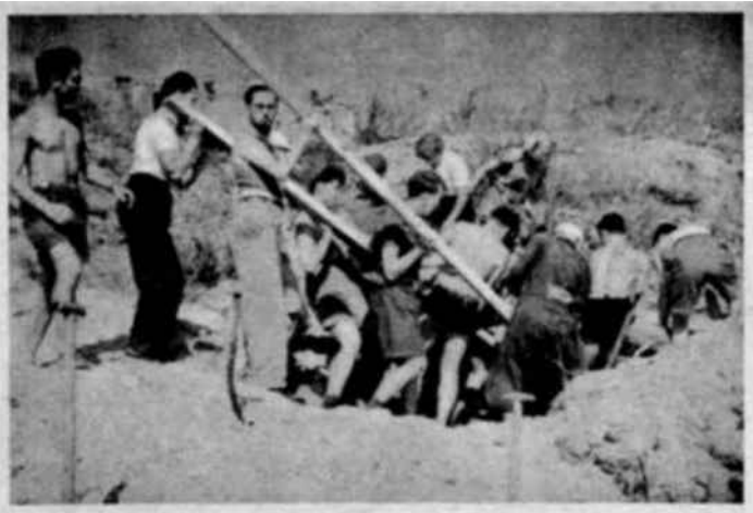
ET DE LEURS EPEES, ILS FORGERONT DES SOCS... Sur la petite île hollandaise d'Ameland, un groupe de trente volontaires de onze pays construisent un « home de vacances » sur l'emplacement d'une ancienne station allemande de radar. Munis de pics, de pioches, de marteaux, ils travaillent à une œuvre de paix et de fraternité. De leurs efforts est née une chanson — « la Chanson pour Ameland » — symbole de leur travail commun et de l'amitié entre les peuples.
