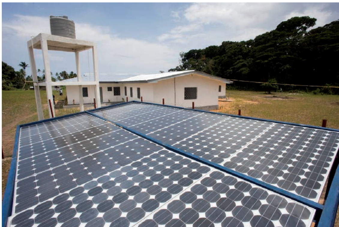
Des panneaux solaires génèrent de l'énergie pour un bâtiment de l'administration locale rénové, construit par le Gouvernement du Libéria. Crédit : ONU Photo/Christopher Herwig.
