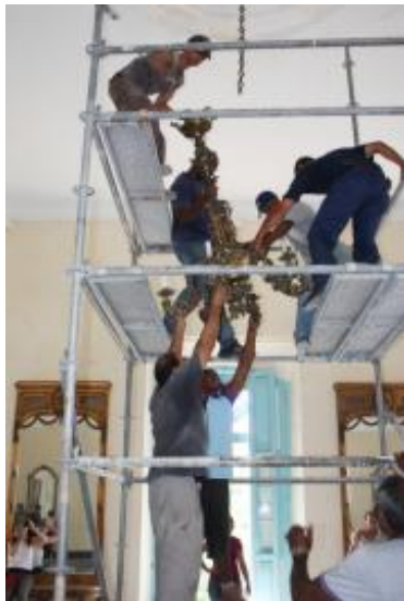
© UNESCO La Habana. Obreros desmontando lámpara de uno de los techos del Palacio.
