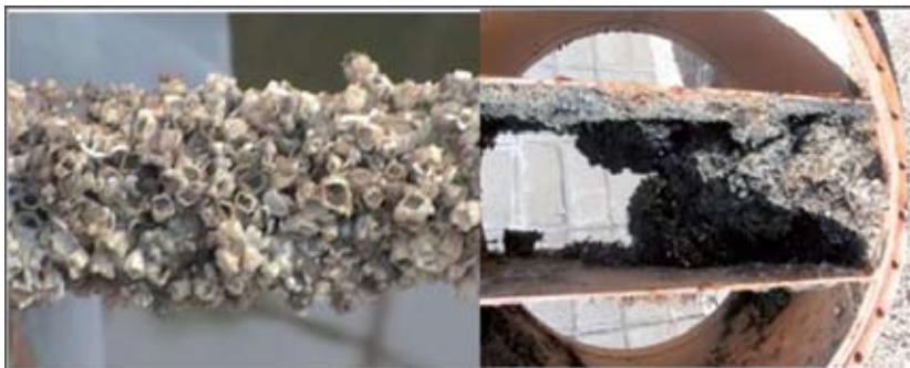
Figura 7. Sistema de refrigeración Refinería La Teja-ANCAP, afectado por organismos incrustantes
