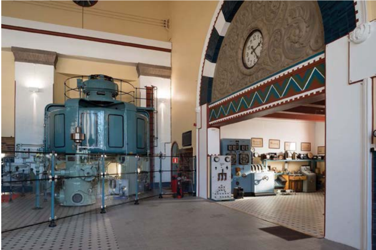
Centrale électrique Tinfos II
