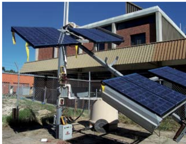
Construction, l'année dernière, d'un prototype de mini réseau électrique associant des transformateurs d'énergie solaire et éolienne et une mini station hydraulique avec un générateur diesel conventionnel. Ce système fournira de l'énergie et de l'eau purifiée en Indonésie
