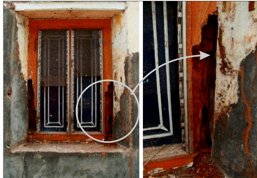
Fig. 188: Decayed window frames should be repaired by adding new wood Gbr. 188: Jendela yang mengalami kerosok pada kayu perlu dilakukan perbaikan dengan cara penambalan atau penyambungan dengan kayu baru
