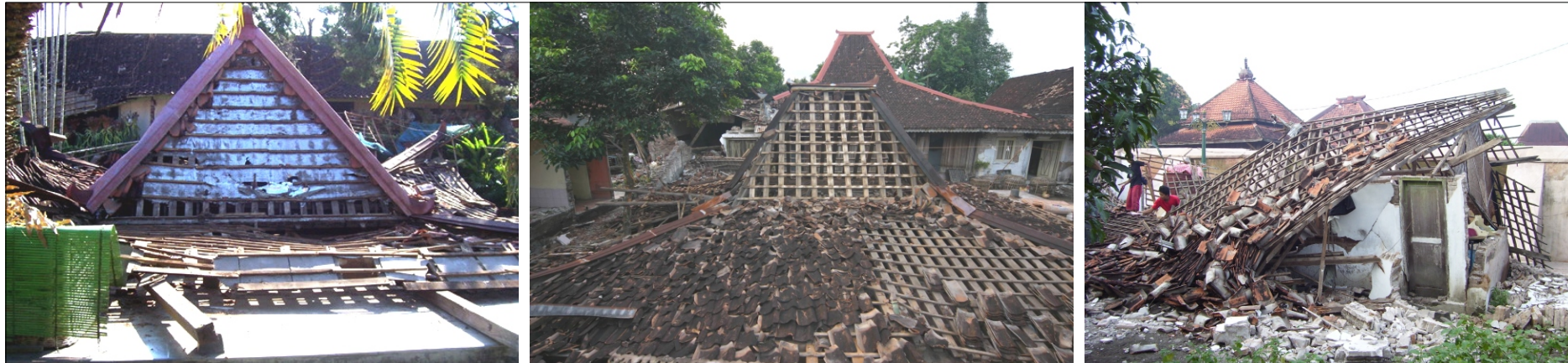
Fig. 189: Damage to the roof cover. Roof tiles usually break when buildings collapse. Gbr. 189: Kerusakan pada penutup atap. Genteng biasanya pecah pada waktu bangunan runtuh.
