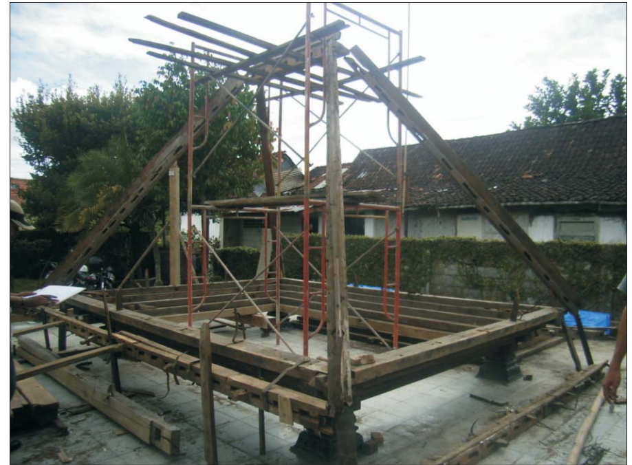
Fig.166: Reconstruction trial to identify the original shape of the building and to support the process of drawing and reconstruction (step 4) Gbr. 166: Ujicoba rekonstruksi untuk menemukan bentuk asli bangunan dan mempermudah dalam proses penggambaran dan rekonstruksi (tahap 4)
