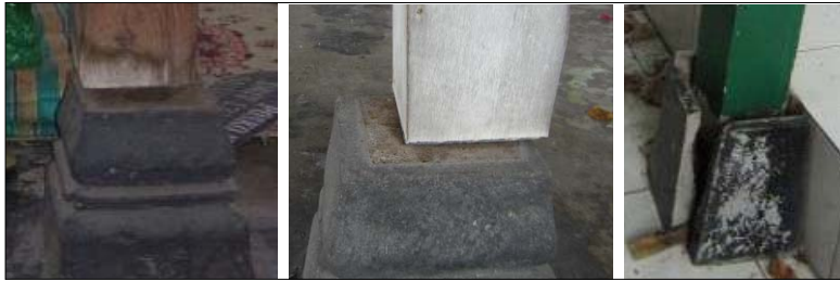
Fig. 181: Column that was displaced from its umpak (base) Gbr. 181: Tiang yang bergeser dari umpaknya karena purus patah
