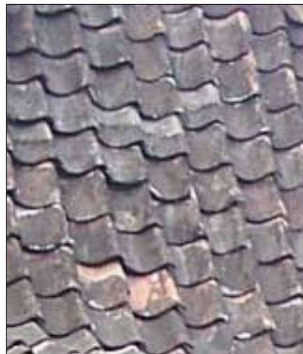
Fig. 120: The kripik clay roof tile in the pendapa Gbr. 120: Genteng tanah liat kripik pada pendapa
