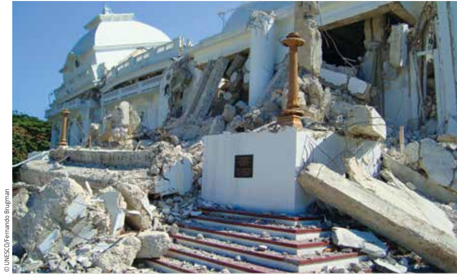
Damage caused by the earthquake in the Palais National d'Haiti. 2010 Dommages causés par le tremblement de terre au Palais national d'Haiti. 2010 Danos causados pelo terremoto ao Palais National d'Haiti. 2010
