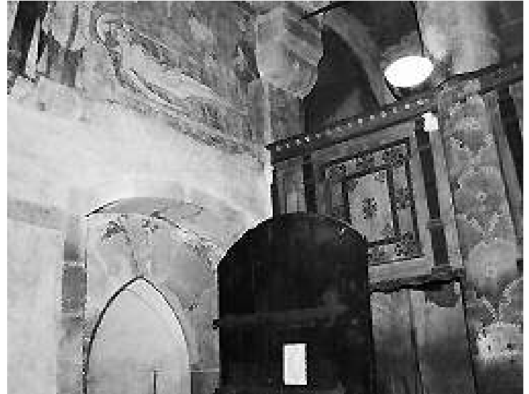
Instalación de detectores de movimiento en un interior de época Foto: Pavel Korda
