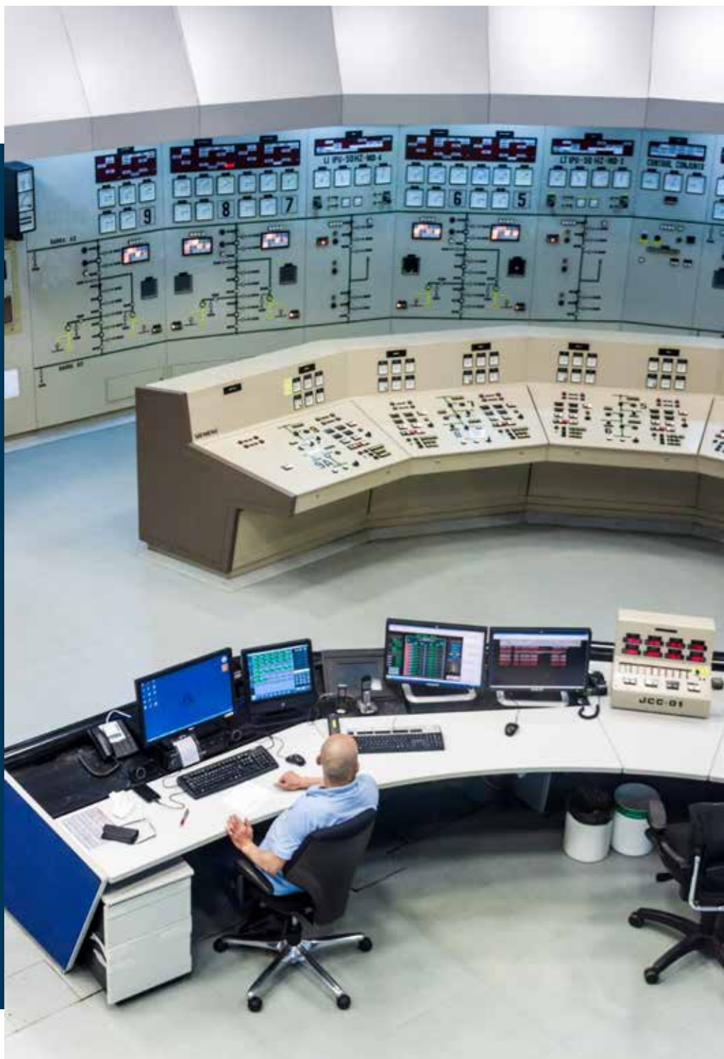
Salle de commande du barrage d'Itaipu sur la rivière Paraná, à la frontière du Brésil et du Paraguay Photo : © Matyas Rehak/Shutterstock.com
