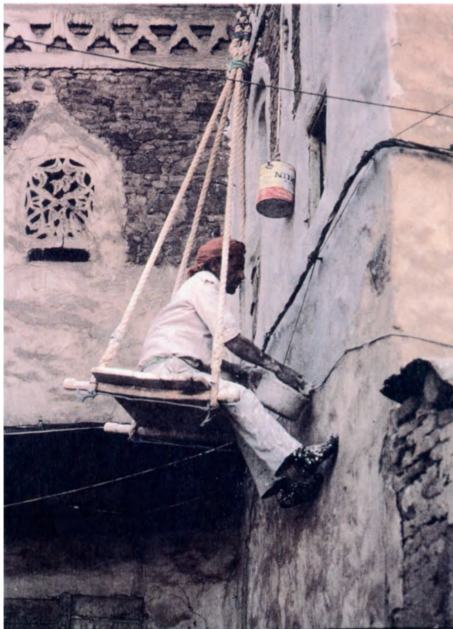
Page de gauche, vue générale de la vieille ville de Sana'a, vers l'ouest. A droite, un maçon refait l'enduit d'une maison.
