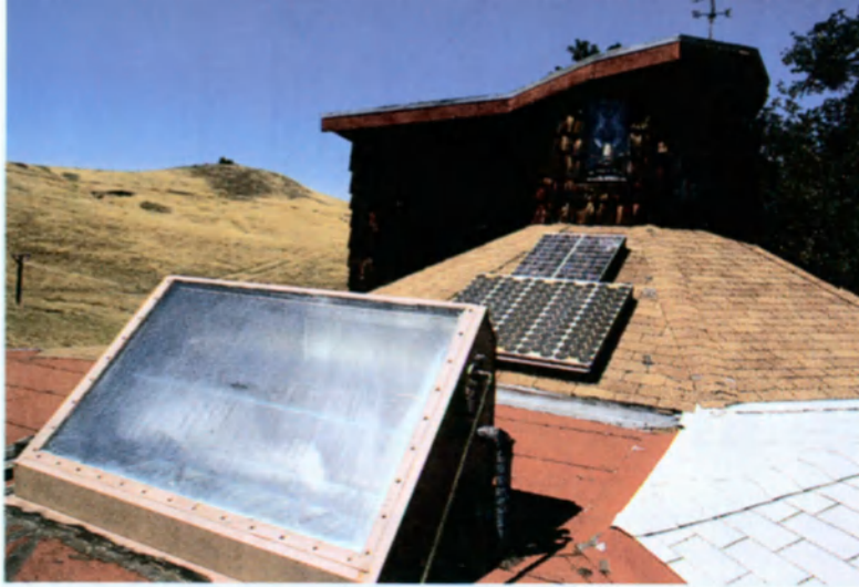
Panneaux solaires sur le toit d'une maison particulière (Etats-Unis).
