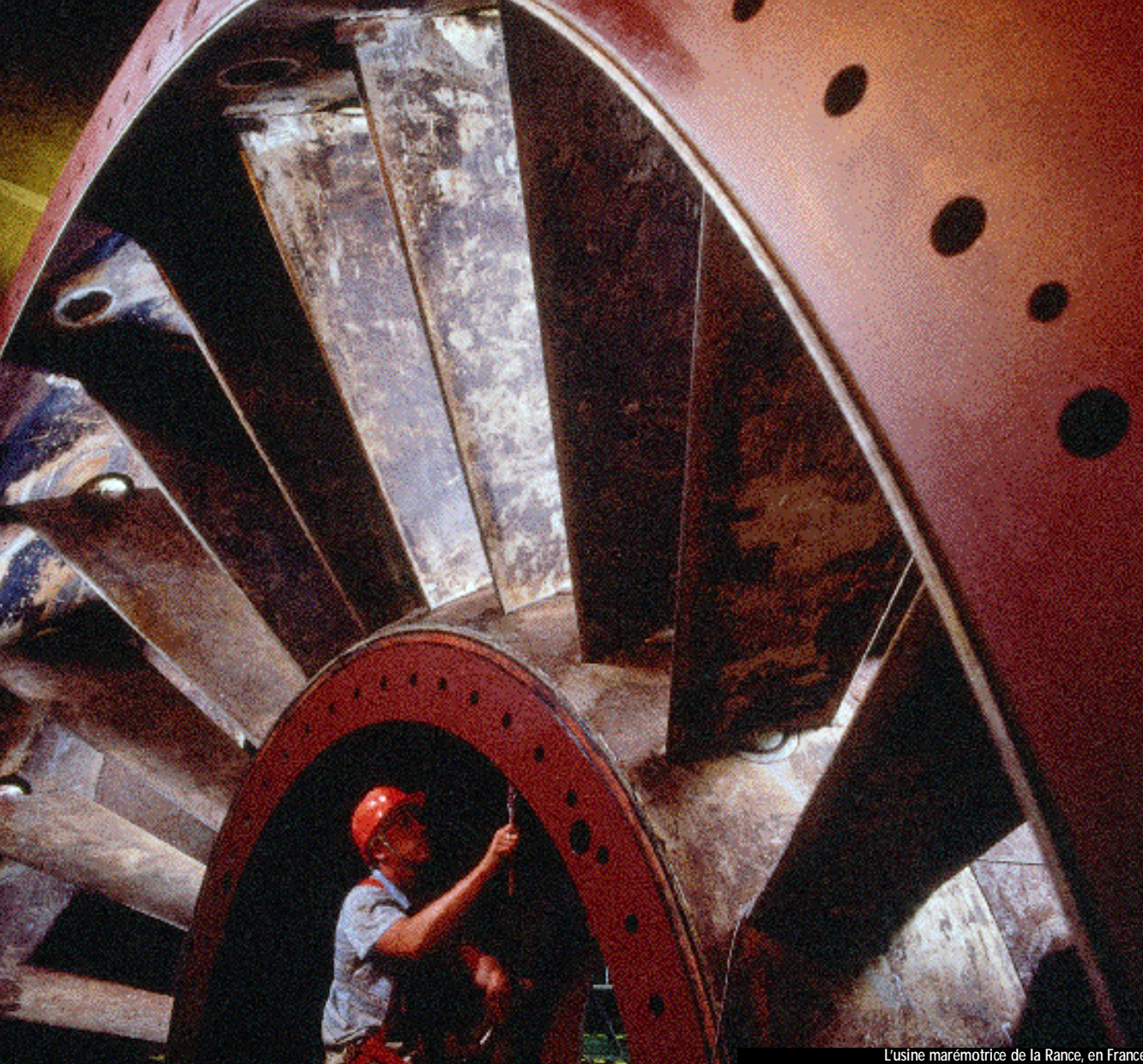
L'usine marémotrice de la Rance, en France
