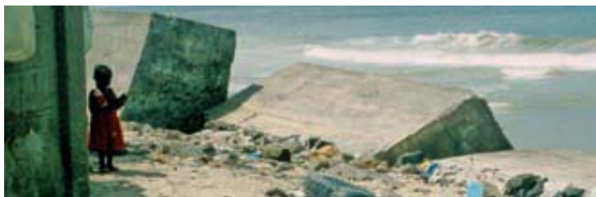
Déchaussé par la houle, le mur de Rufisque s'est écroulé.
