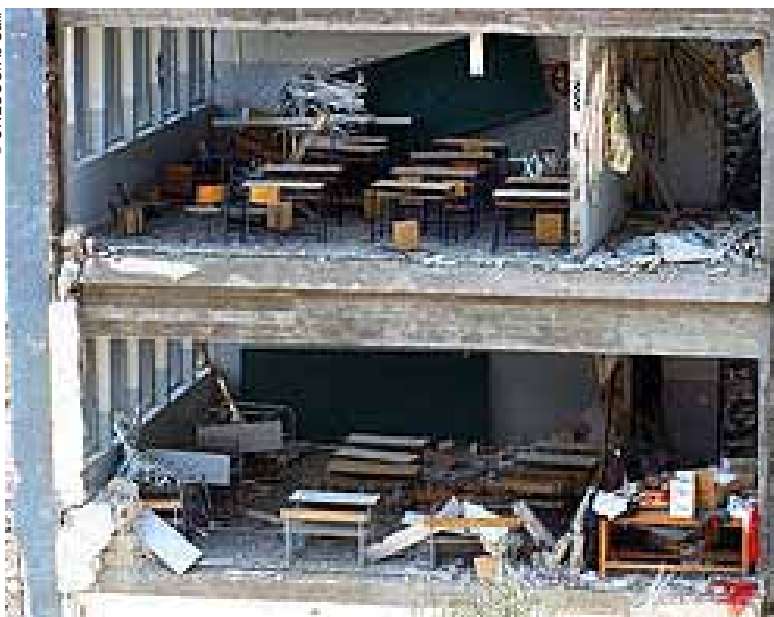
Ecole endommagée à Bing Jbeil.
