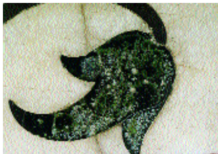
Detalle de un muro del Taj Mahal dañado por el "cáncer del mármol".
