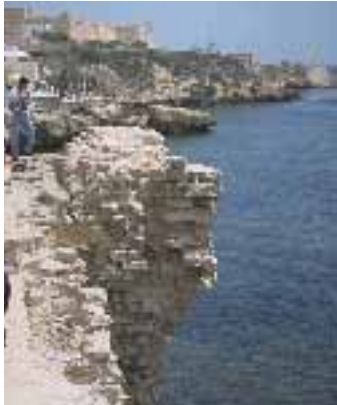
Le Borj de nos jours et l'érosion des fondations des anciennes fortifications
