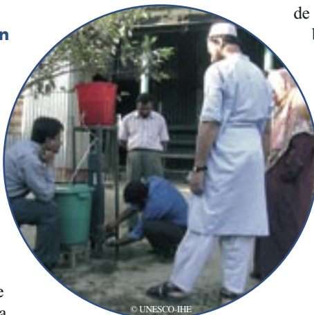
Instalación de uno de los filtros familiares en el jardín de la familia Gafur, de 10 miembros, en Dhunshi
