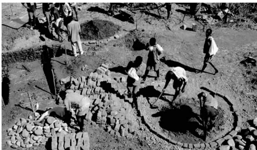
© Joe Mu Igan, EWB - UK 在肯尼亚基贝拉与当地居民一起混合水泥修建桥梁锚锭
