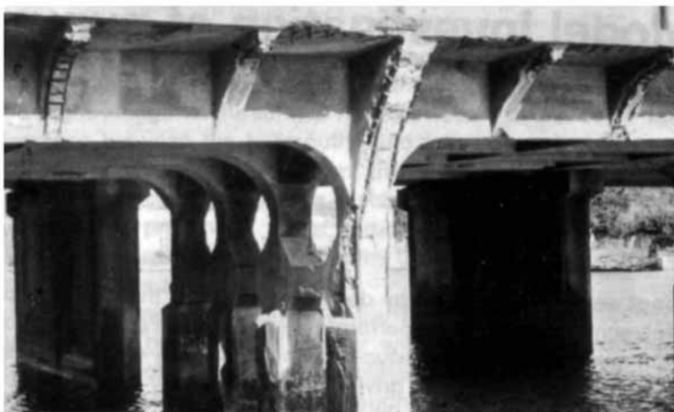
© SAICE 迫切需要维修的混凝土桥梁
