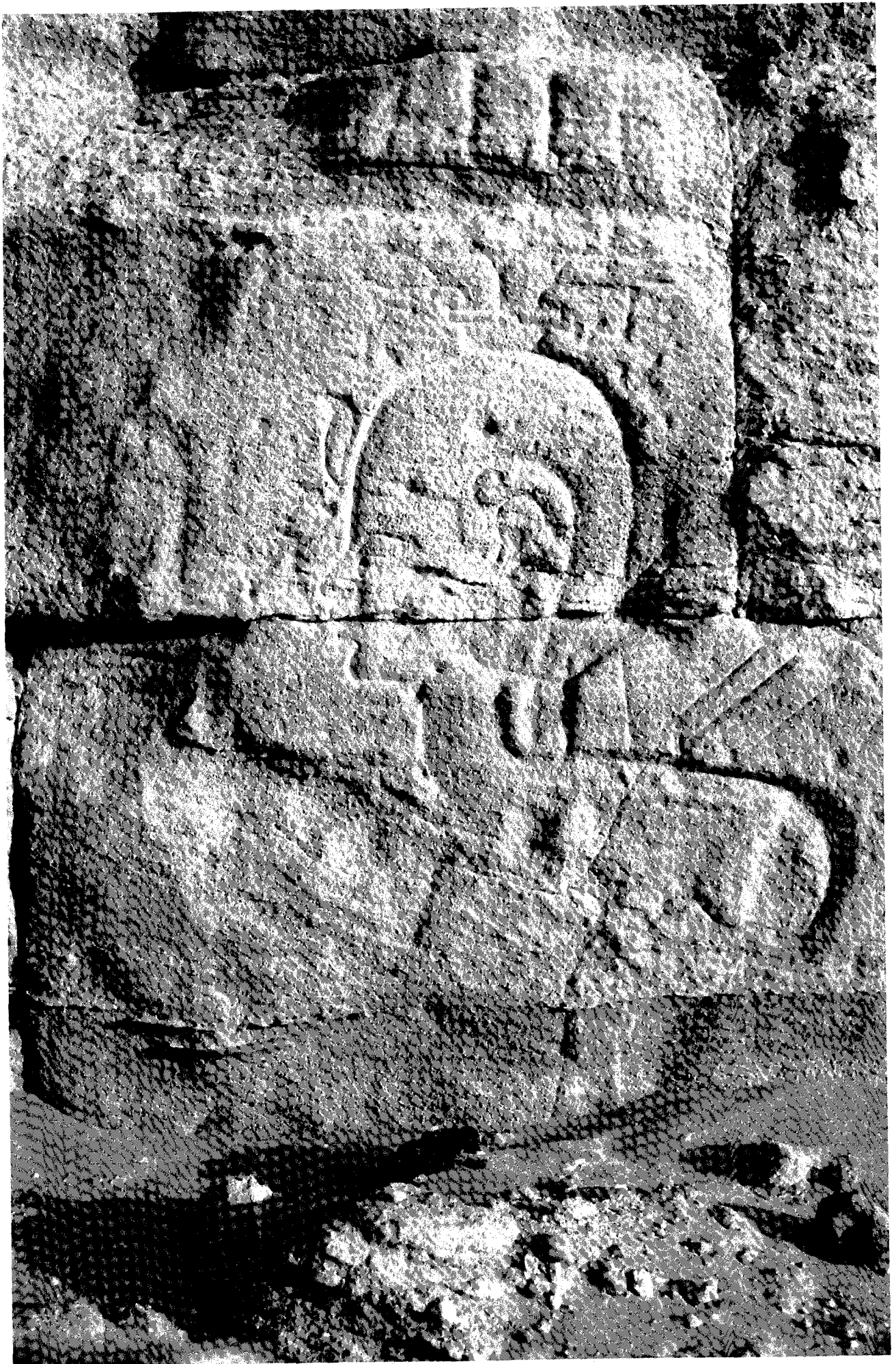
Dégradation due à l'érosion éolienne
