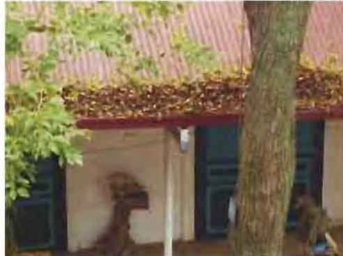
État des gouttières
