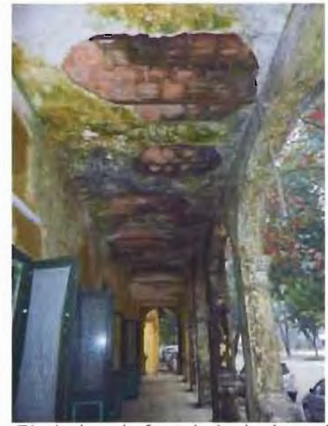
Etat du plafond de la loggia
