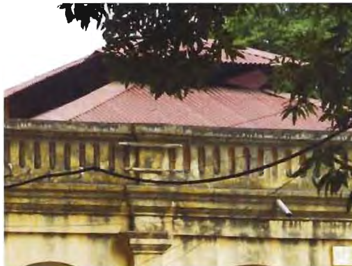
Etat de la balustrade
