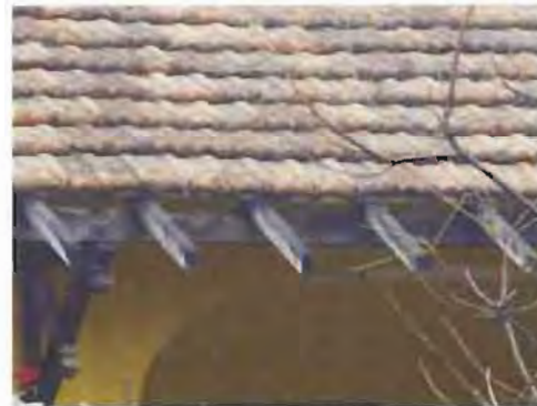
Etat de la couverture en tuile
