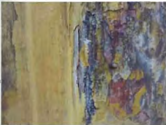
Etat des enduits
