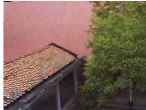
Trace de végétation sur couverture terre cuite
