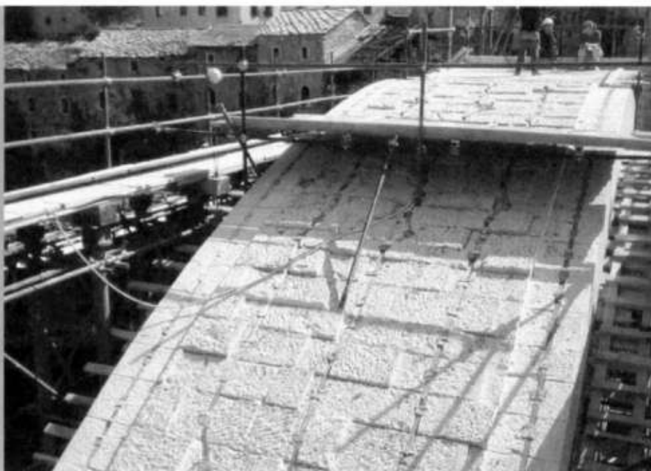
8. La nouvelle arche du pont, reconstruite avec la technique d'origine, en utilisant de l'acier inoxydable.
