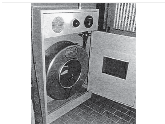
3 屋内消火栓 Hydrant (inhouse)
