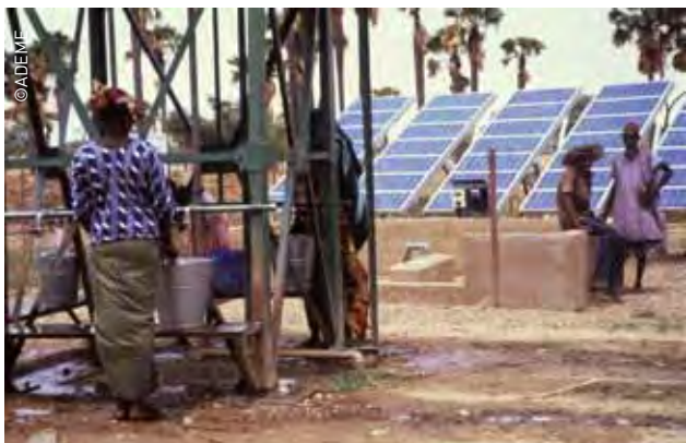
Energia solar para bombeamento de água.
