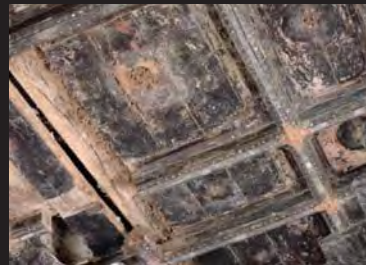
โครงสร้าง หลุดหาย
