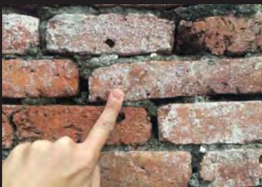
คราบขาว Efflorescence
