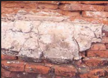
รอยร้าวที่ผิว Minor Cracks
