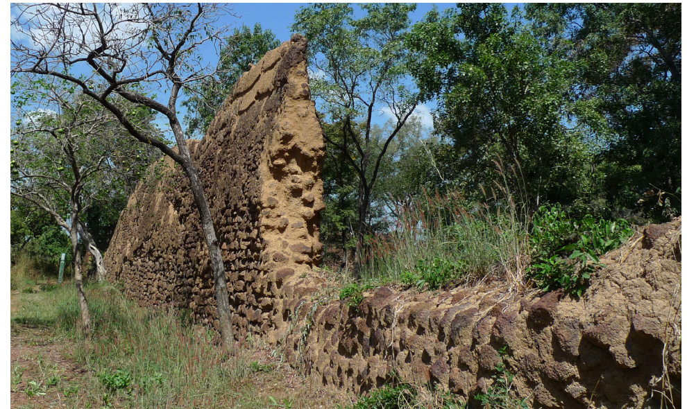
Arrachement dans le mur ouest © David Gandreau, CRAterre
