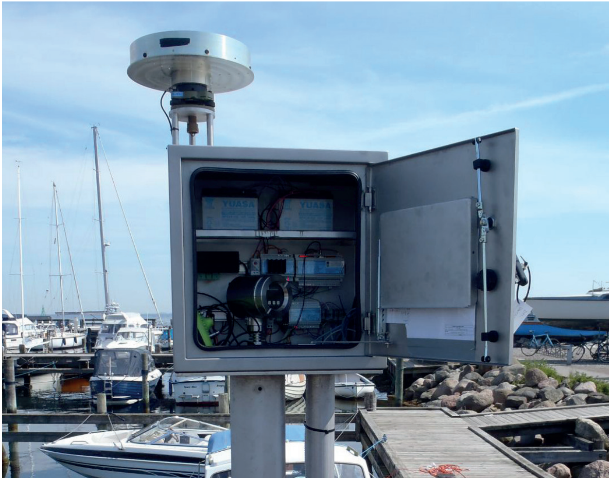
Figure 4.6 Une installation à Dragør, Danemark. À gauche on peut voir un marégraphe radar Endress+Hauser monté au sommet d'un tube en acier inoxydable (environ 17 cm de diamètre) qui sert de puits de tranquillisation et de guide d'ondes. Ce tube est muni à son extrémité d'un trou d'admission de 30 mm de diamètre. À l'intérieur du tube se trouve un filtre destiné à empêcher les intrusions biologiques. Le sommet du tube comporte 4 trous munis de filtres destinés à empêcher la condensation sur l'antenne du radar. À droite on peut voir un tube en acier inoxydable contenant les câbles du capteur de pression. (Photo de l'Institut Danois de Météorologie).
