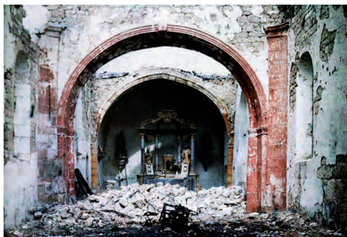
Destruction d'une église en Europe au cours d'un conflit armé.
