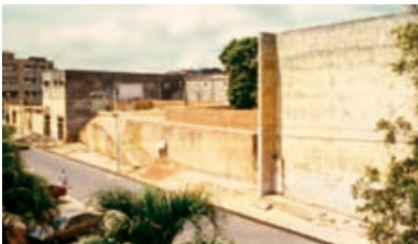
Daños en el entorno de la Muralla de Santo Domingo.
