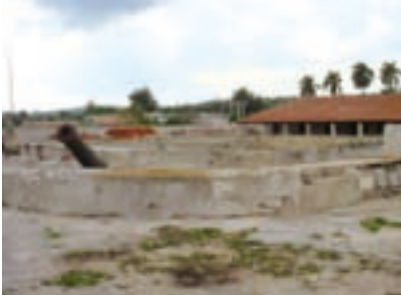
Transformaciones del baluarte sureste (San Antonio) del frente de mar, eliminación de la garita y los parapetos.
