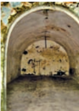
Bóveda de la nave oeste con graves problemas de humedad.
