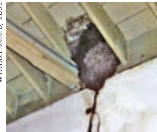
Termitero ubicado en la cubierta de madera de un local de la casa del Gobernador.
