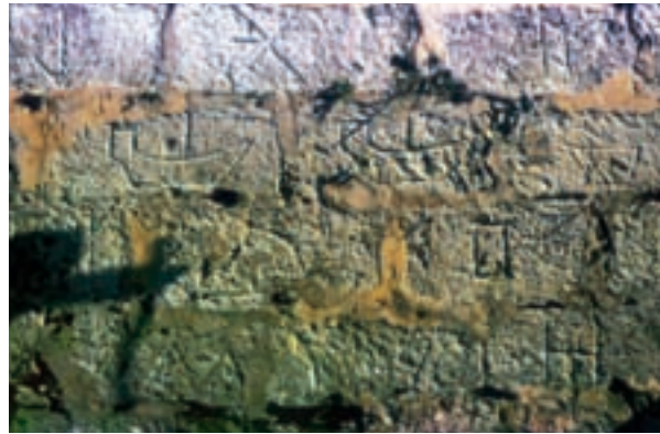
Marcas de canteros grabadas sobre la cantería de los lienzos del Castillo.
