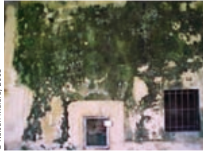
Hongos y eflorescencias en un muro saturado de humedad.
