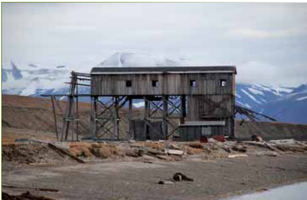
L'un des bâtiments industriels endommagés par la rouille et les moisissures (photo : Susan Barr).
