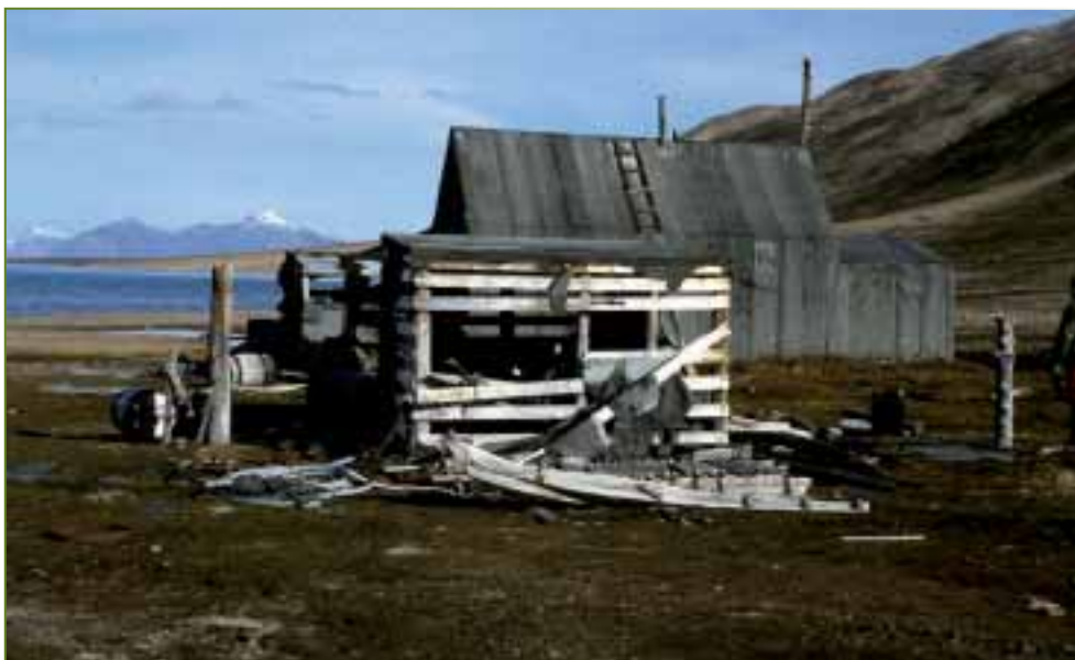
Dans la région du nord-est du Groenland, cette cabane de trappeurs, de taille relativement importante, construite en 1930, a été totalement détruite par une fonte des neiges sans précédent qui a entraîné des glissements de terrain pendant l'hiver 1995 (photo : Susan Barr, 1991).
