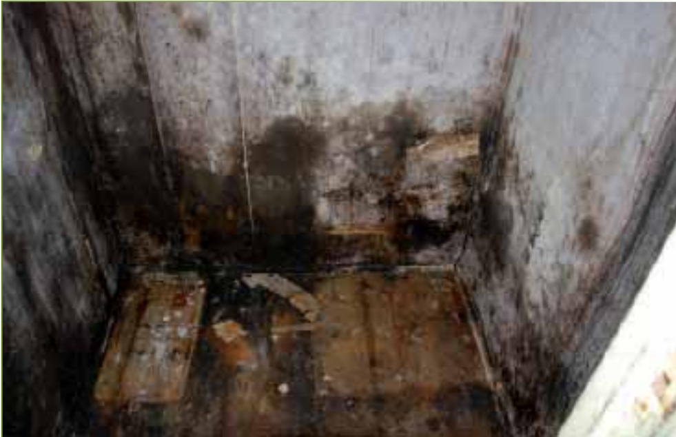
Un cas sérieux de moisissures découvert en 1957, à l'intérieur d'un bâtiment classé, dans le nord-est du Svalbard (photo: Susan Barr).
