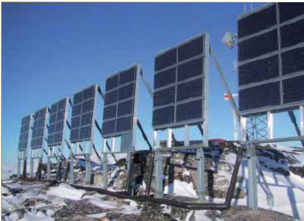
Panneaux solaires d'une station-relais sur une colline située dans l'ouest du Groenland (photo : Tele Greenland Ltd.).
