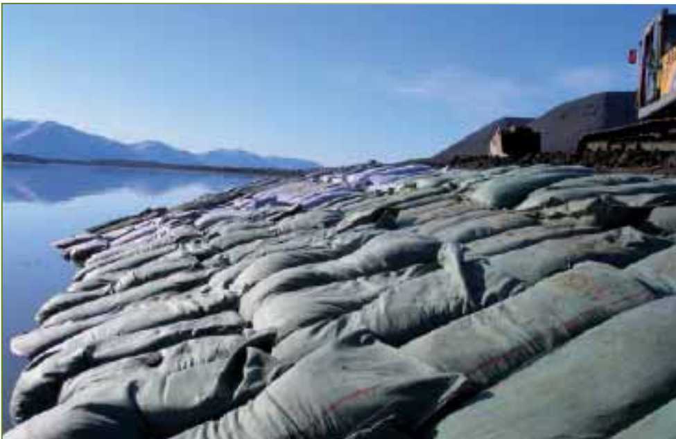
Essai d'un nouveau matériau géosynthétique pour protéger, à l'aide de sacs de sable, les sites côtiers menacés d'érosion (photo : SINTEF, Trondheim).
