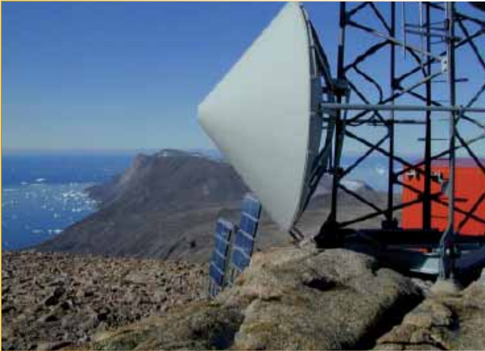
Une station relais équipée de panneaux solaires sur le sommet d'une colline (photo: Tele Greenland Ltd.).
