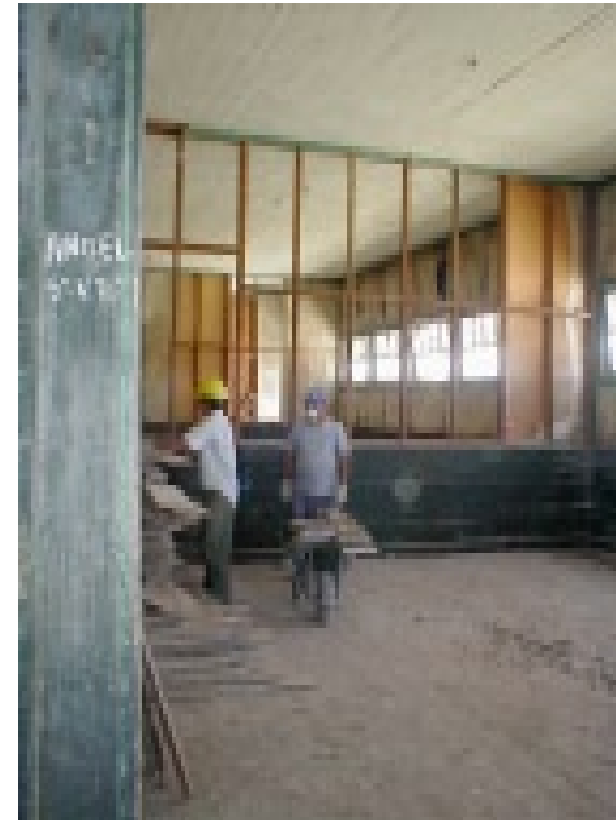
Obras en una de las salas de la Escuela E-35. Pulido de maderas y reposición de tabiques rotos Working in one of the classrooms of the E-35 school. Polishing wood and replacing broken walls Eugenio Correa, enero | January 2003
