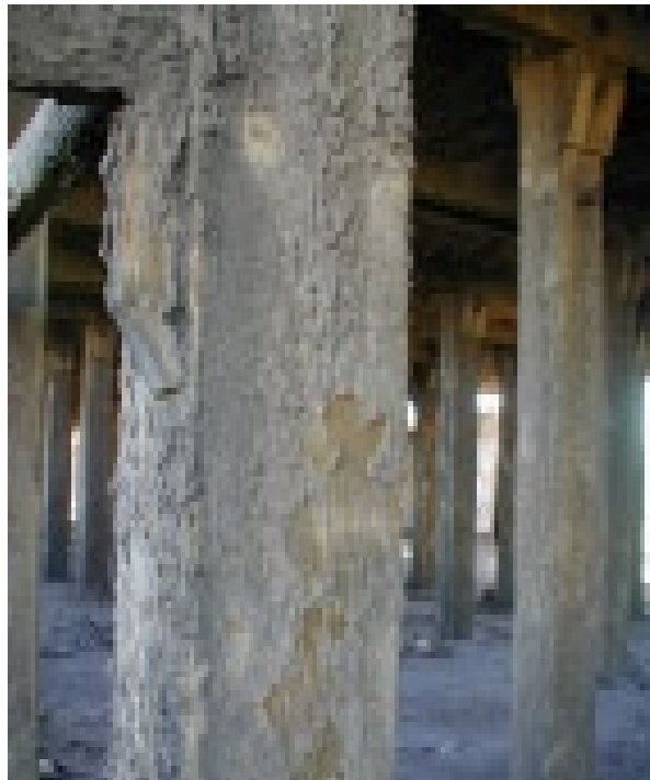
Pilares de Pino oregón erosionados Douglas Fir pillars eroded Eugenio Correa, 2003
