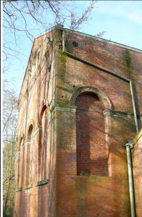
problème de gestion des eaux de pluie intervention à prévoir
