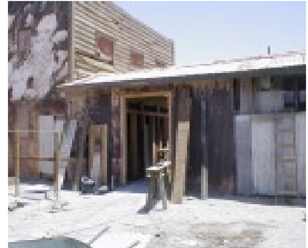
Obras en los baños de mujeres de la Escuela. Habilitación para el uso de los visitantes Working in the ladies' bathroom at the school. Preparing it for use by visitors Eugenio Correa, enero | January 2003
