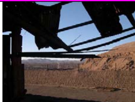
Detalle del estado de las calaminas del techo
