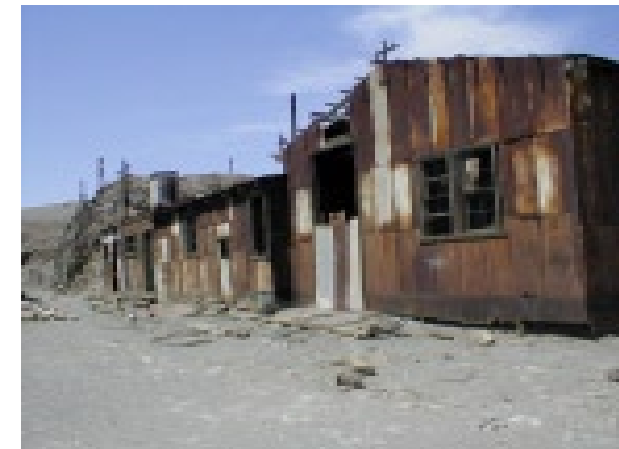
Edificio Industrial de Humberstone con sus revestimientos de metal (calaminas) absolutamente corroidos | Industrial Building with metal coverings (calamines), totally rusted Eugenio Correa, 2003
