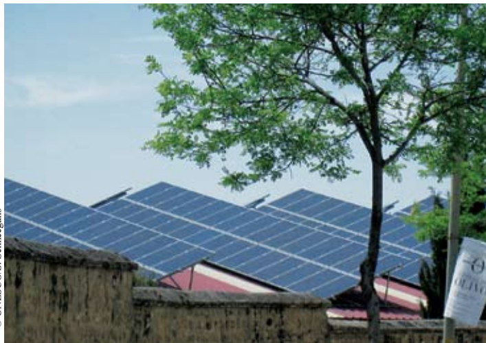
Panneaux solaires sur le toit d'un stade à Baeza en Espagne
