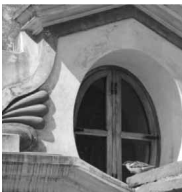
Mano de obra esclava. Muros, Detalle de muros, mecinales, andamios (reconstrucción), y óculo de la cúpula. Estancia Jesuítica de Alta Gracia. Archivo MNEJAGyCVL
