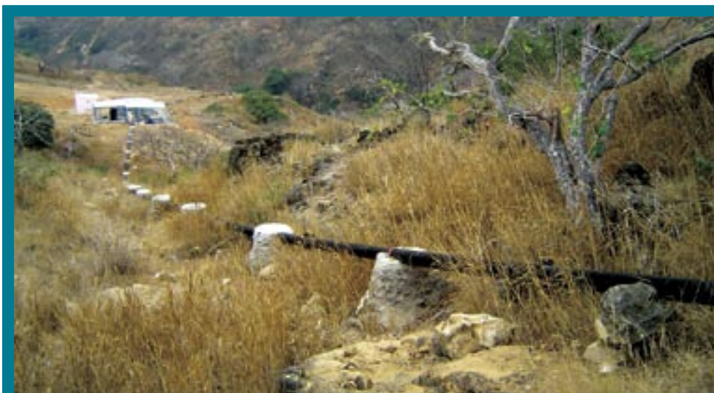
VISTA PARCIAL DE UM SISTEMA DE ABASTECIMENTO DE ÁGUA, POMBA NOVA, SUMBE
