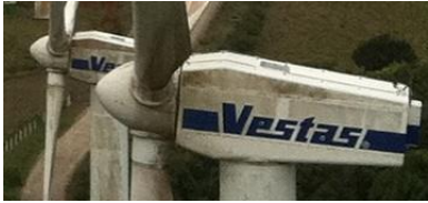
Figura #26. Góndola o Nacelle de una turbina eólica Vestas
