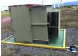
Figura #28. Transformador de acople a la red distribución en el parque eólico de AEROENERGIA
