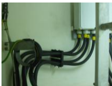
Figura #6. Cableado de potencia conectado al generador
