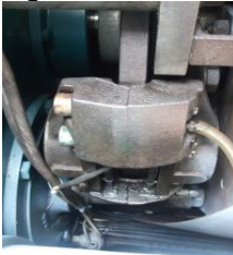
Figura #22. Vista de perfil de sistema de frenado de una turbina eólica
