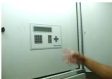
Figura #8. Técnico configurando los parámetros en el PLC
