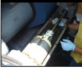
Figura #24. Vista interna de la corredera del pistón hidráulico del control del ángulo de las aspas
