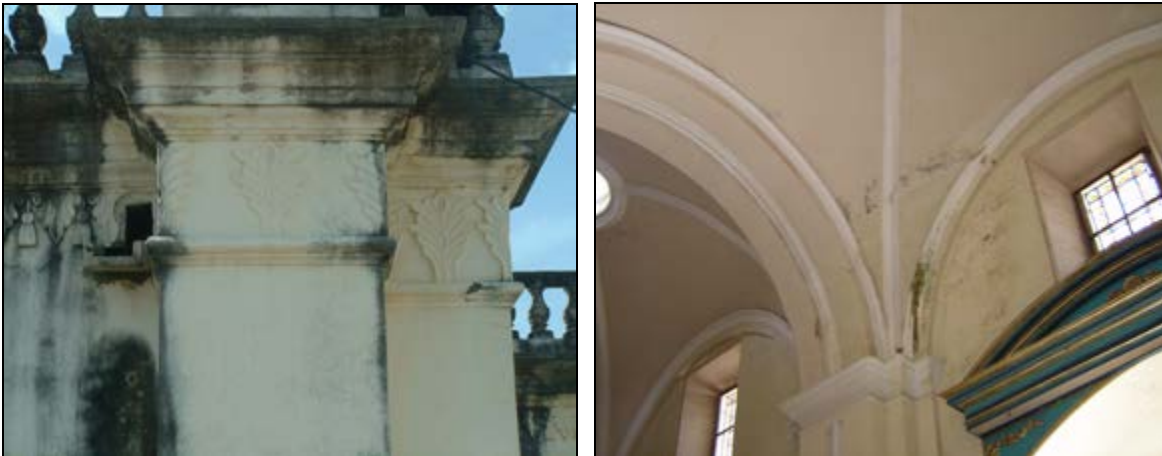
Détérioration d'un collatéral : extérieur et intérieur
