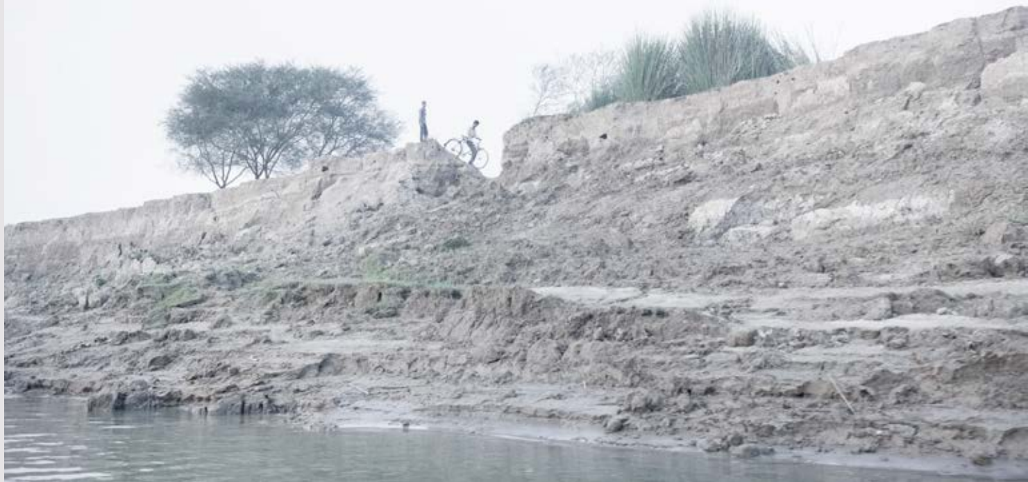
Deux hommes avancent prudemment le long d'une berge effondrée.
