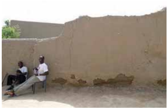
Dégradation naissante – derrière bâtiment écroulé
