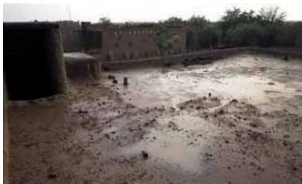
La toiture lors de la pluie du 18 juillet
