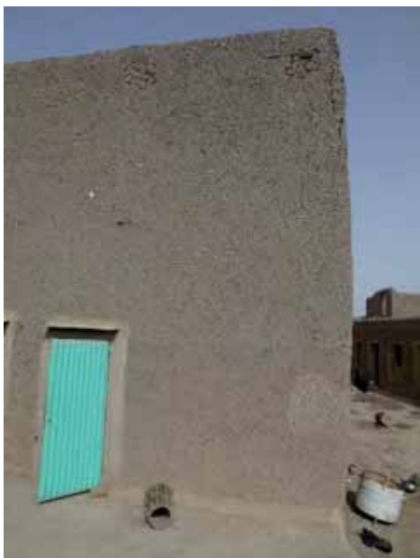
Angle nord est et façade est (fissure / érosion de l'enduit)
