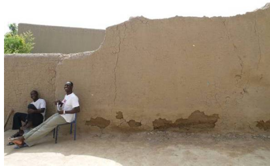
Dégradation naissante – derrière bâtiment écroulé
