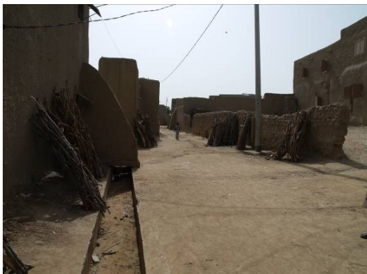
Canal en partie obstrué, bas de la rue Sankoré
