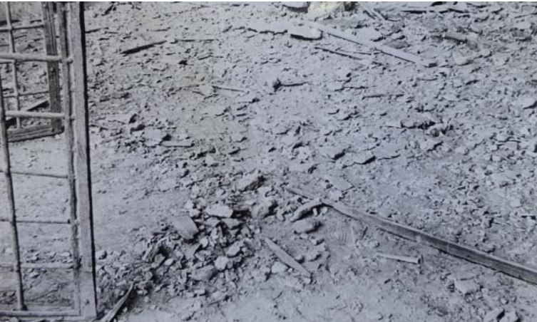
Figure 3. Viterbo, chapelle Mazzatosta au printemps 1944, après les bombardements aériens. On note les nombreux fragments d'enduits peints qui couvrent le sol. © MIBAC, ISCR, Rome, AF*.
